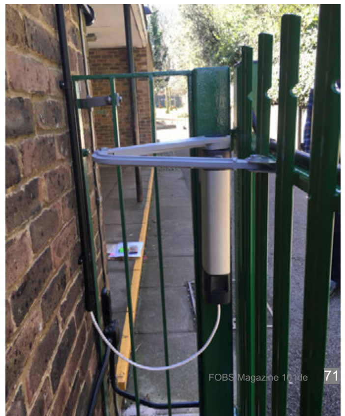
Das gleiche Tor von innen. Eine weitere Gefahr des Einklemmens zwischen Torantrieb und Wand.
